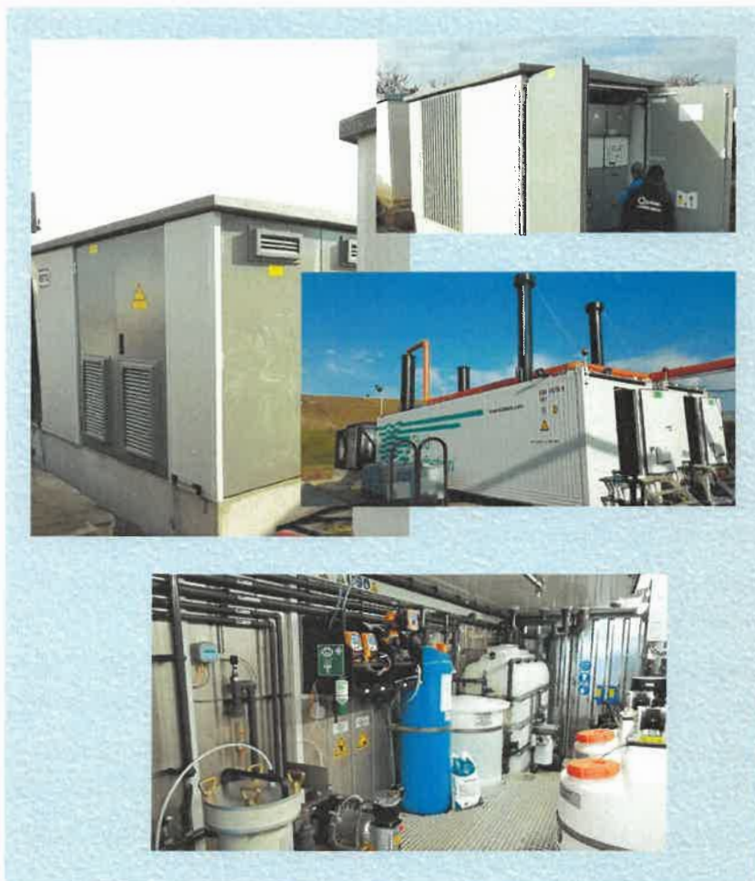
Investiții protecția mediului – alimentare electrică depozit deședuri nepericuloase Ghizela
